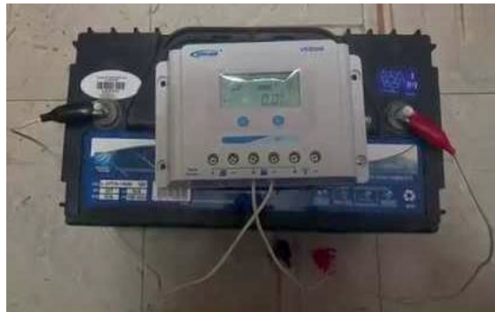
Figura 9. Controlador de carga EPSOLAR 6A conectado a la batería
